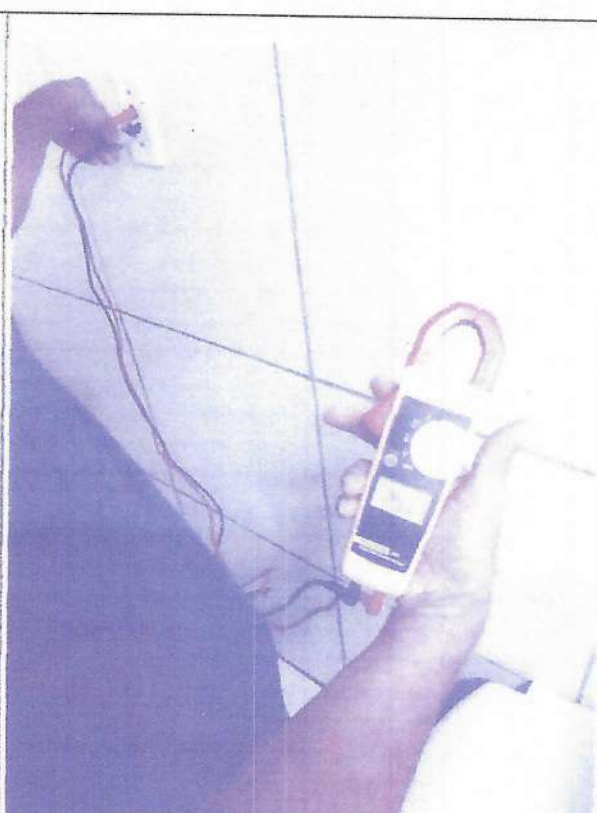
Foto VIII: Tensão de circuito de tomadas da cozinha.
