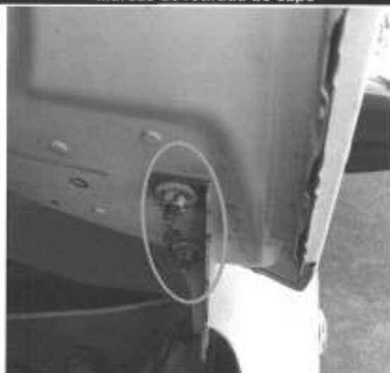
Marcas de retirada do capô
